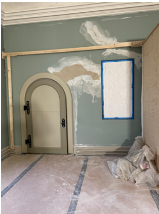
Skader på kirkens vægge
