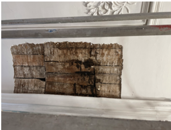
Loftsbrædder, rørvæv og pudslag er skadet af varme fra skorsten
