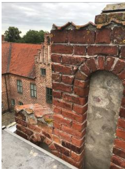
Murværket var i meget dårlig stand.
