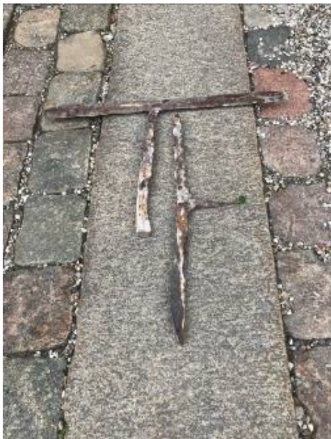
Murbinderne var rustet hhv. skåret over.
