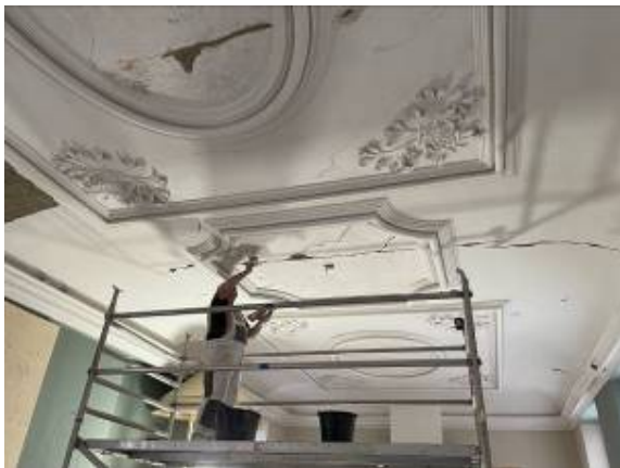
Betydelige skader på kirkens loft reparerer
