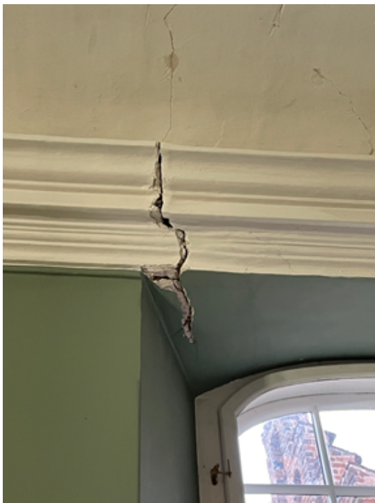
Omfattende revnedannelser på loft og vægge
